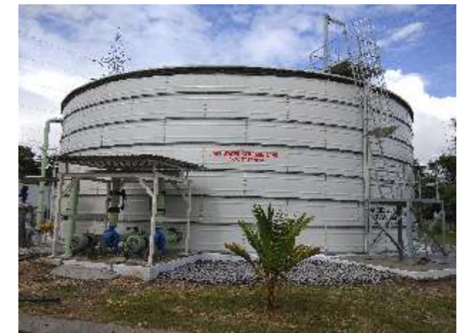
1570 KL. Installed at Bangalore, India
